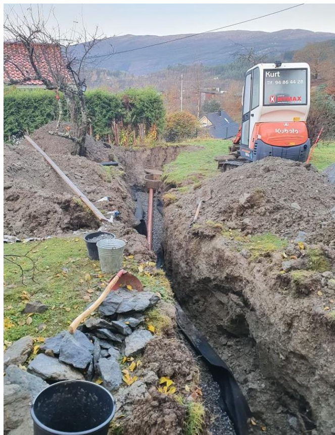
Ny vassledning- Bilde: J-E Mjelstad
