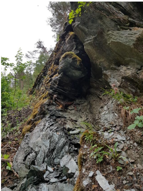
Utrasa mur under Liavegen
